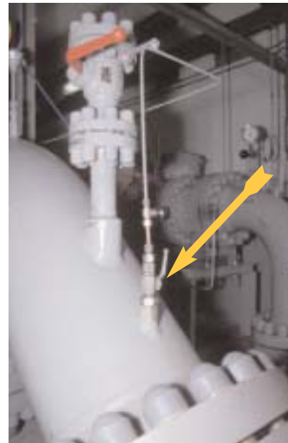
Abbildung: Odorierungsstoff wird dem Gas über eine Vernebelungsdüse beigemischt
