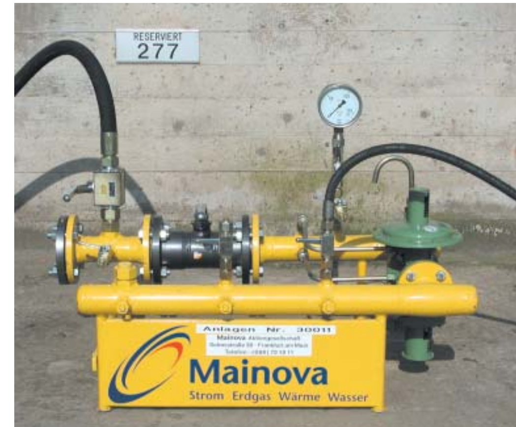
Abbildung: Mobile Gas-Notstation
