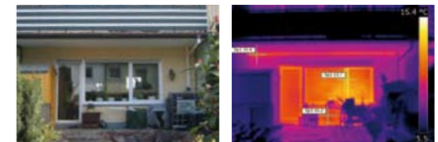
Beispielfoto: Wärmebrücke unter dem Balkon, Verluste durch Fensterrahmen und Heizungs-nische
